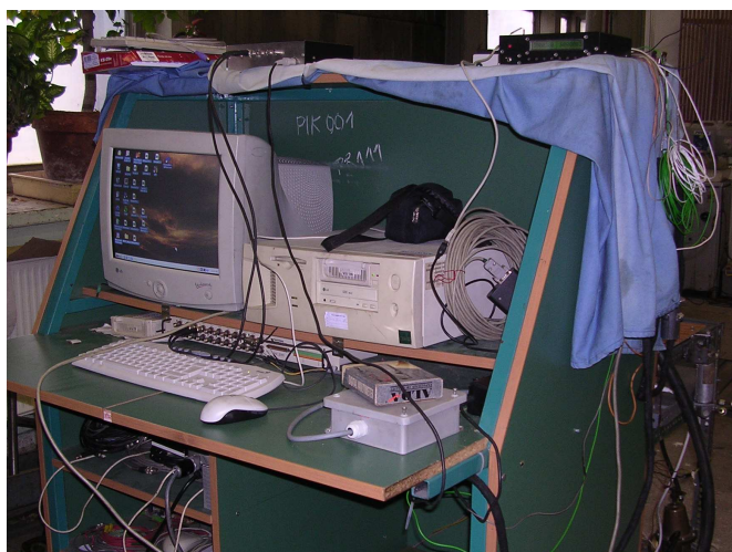
6. kép: A riasztóberendezés programozása Figure 6: Programming of the alarm device
